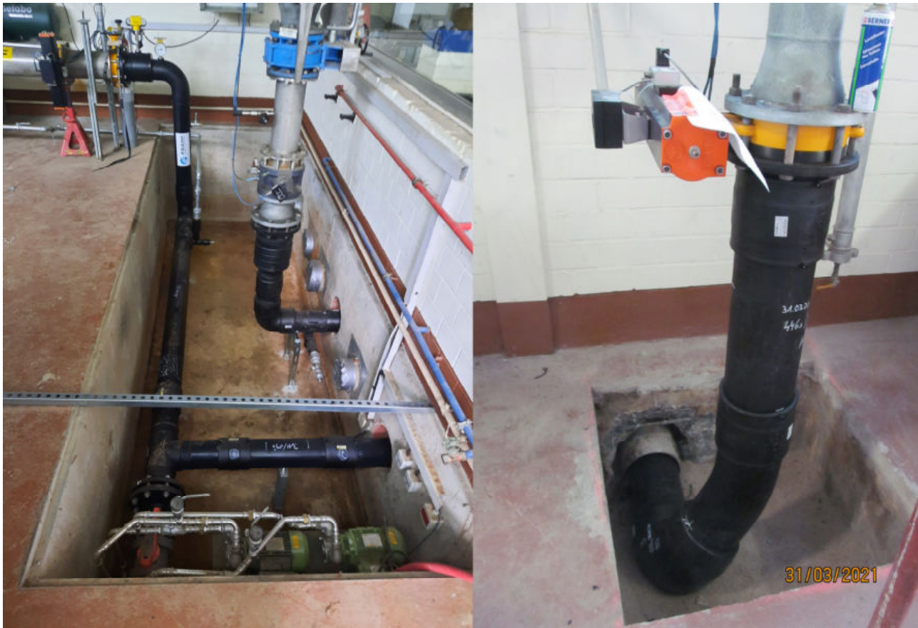
Abb. 4.4: Neuer Sammelbalken in der GÜS (links) und neue Druckleitung zum BHKW (rechts)
